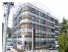
高層化の進む作業環境に効率よく対応
